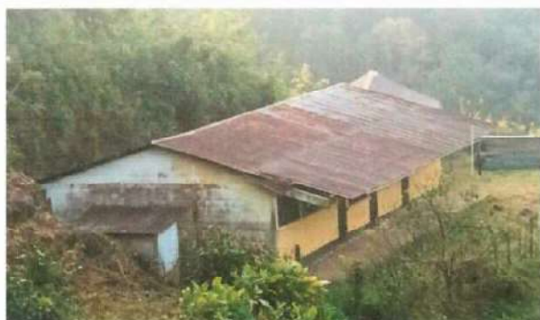
Foto 1: Estado actual de la cubierta de lámina del módulo de aulas con las láminas de zinc oxidadas y deterioradas por el tiempo.
