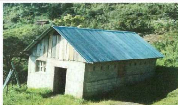
Foto 3: En la cocina requiere sustitución de cubierta de lámina y de estructura de techo de madera por metal, además repello de paredes.
