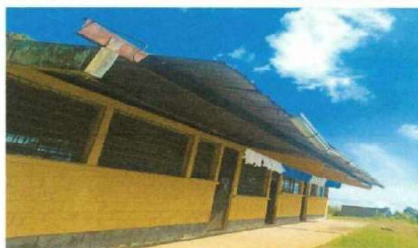
Foto 2: La estructura de techo del módulo de aulas se encuentra oxidada que ameritan mantenimiento.
