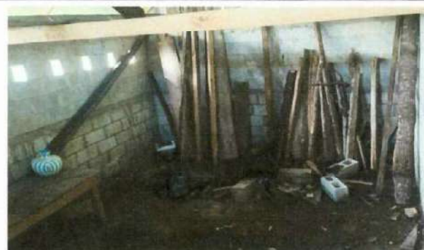
Foto 4: El módulo de la cocina requiere instalación de piso de torta de concreto y sustitución de estufa rural.
